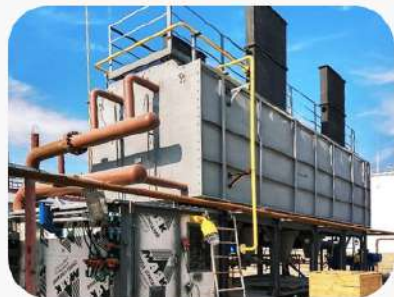
Печи подогрева нефти
